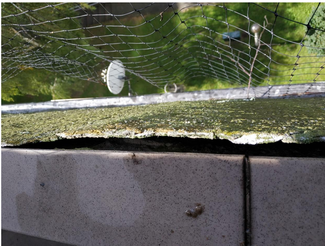
Fot. 7. Odspojony tynk zewnętrzny na balustradzie betonowej – M51
