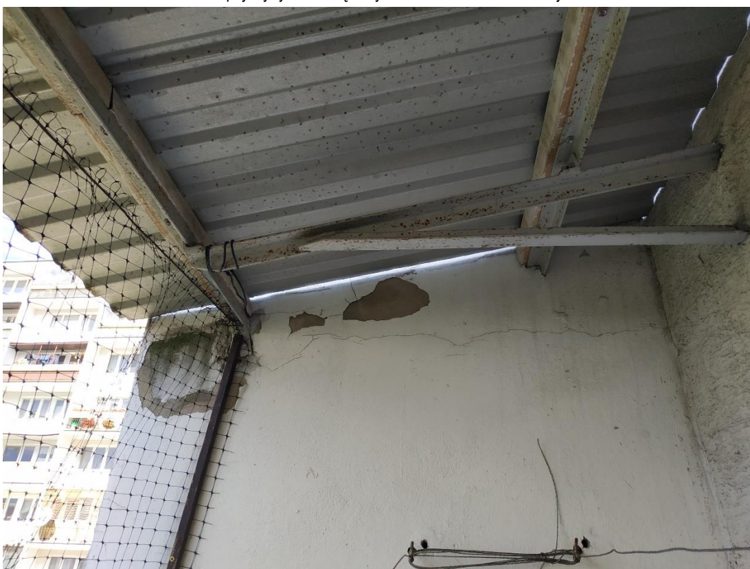
Fot. 8. Brak uszczelnienia pomiędzy zadaszaniem a ścianą boczną oraz ścianą podłużną, zacieki na ścianie bocznej – M51
