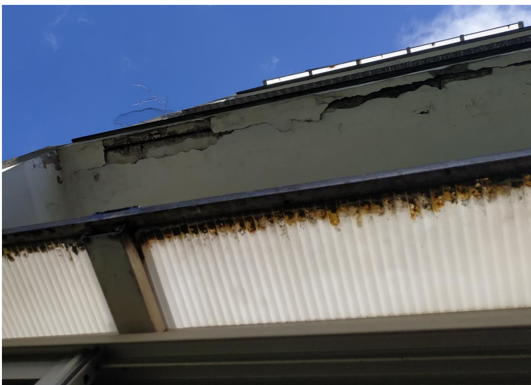
Fot. 6. Korozja zbrojenia dolnego płyty loggii – M51
