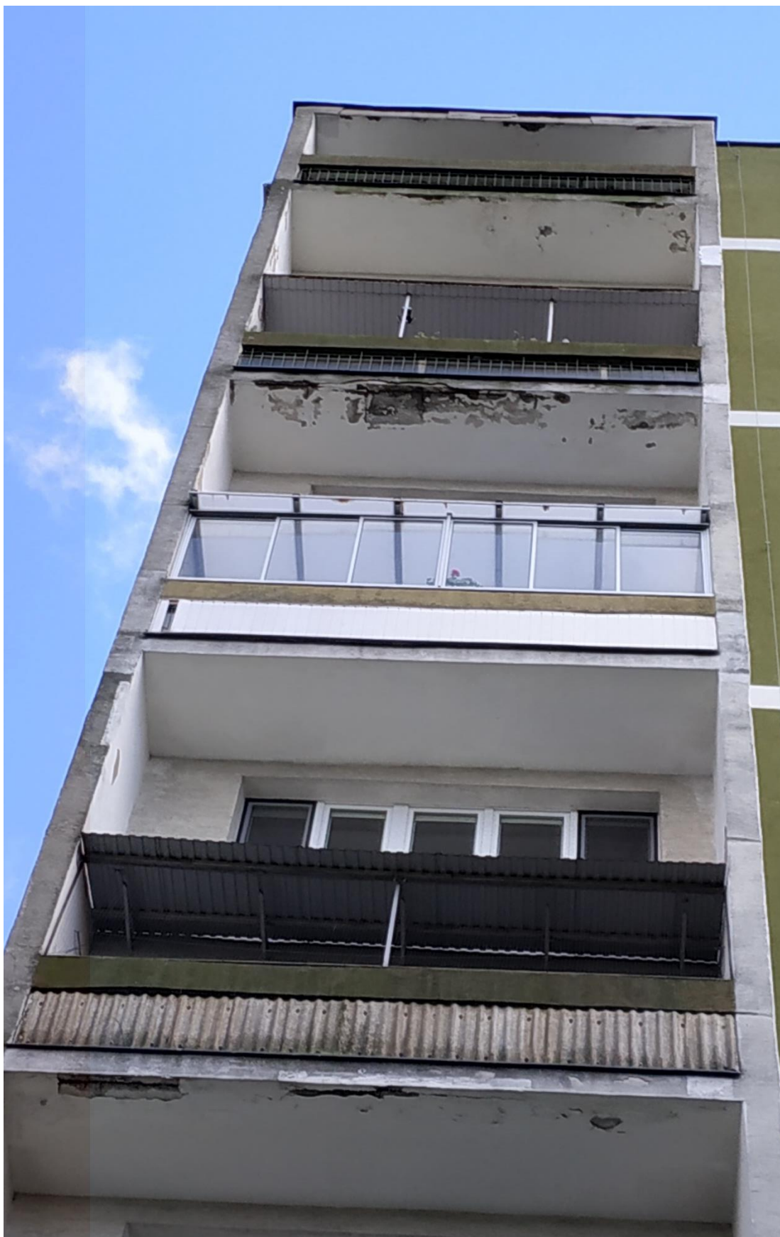
Fot. 2. Widoczne ślady korozji betonu i zbrojenia dolnego płyty loggii
