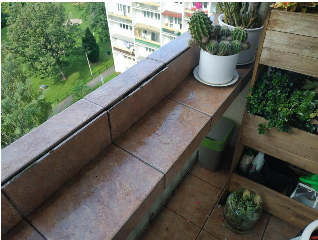
Fot. 3. Odspojone płytki na balustradzie – M39
