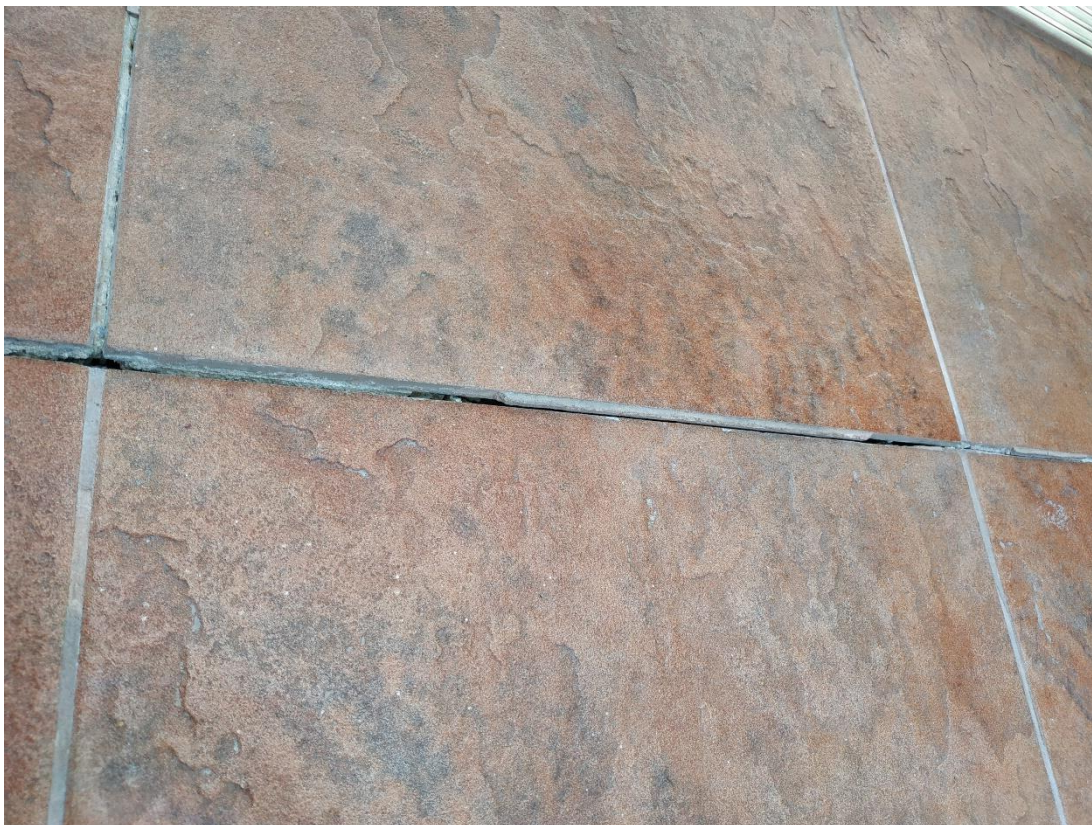
Fot. 5. Odspojone płytki – M46
