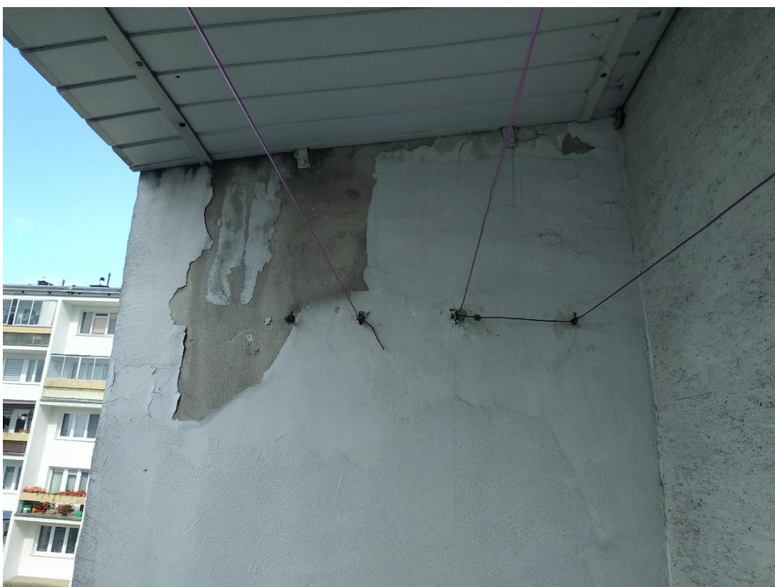
Fot. 4. Łuszczenie farby na ścianie bocznej loggii – M39
